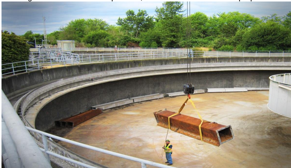
Figura 18. Sedimentador primario, infraestructura similar a la propuesta
