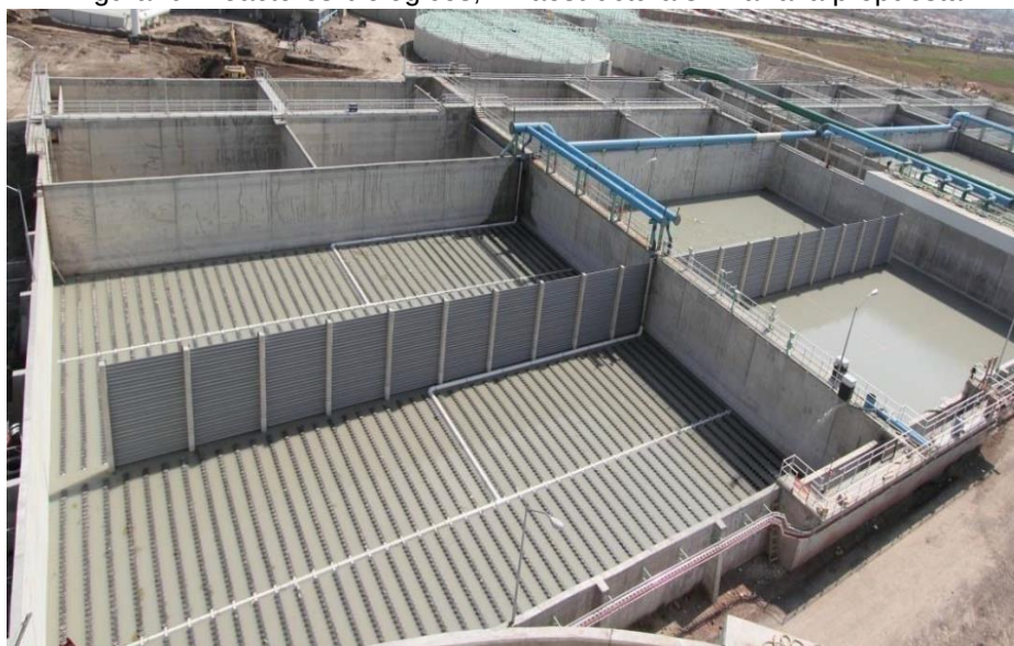
Figura20. Reactores biológicos, infraestructura similar a la propuesta
