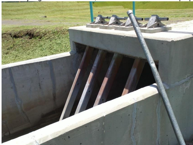
Figura 13. Rejas gruesas manuales, infraestructura similar a la propuesta.
