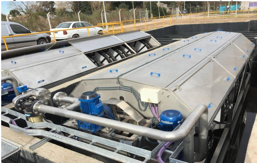
Figura24. Filtros de disco rotativos, infraestructura similar a la propuesta
