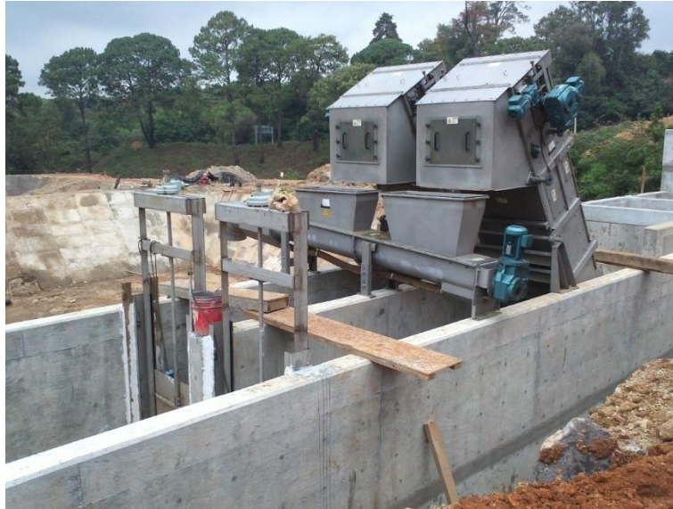
Figura 14. Rejas automáticas y tornillos transportadores, infraestructura similar a la propuesta.
