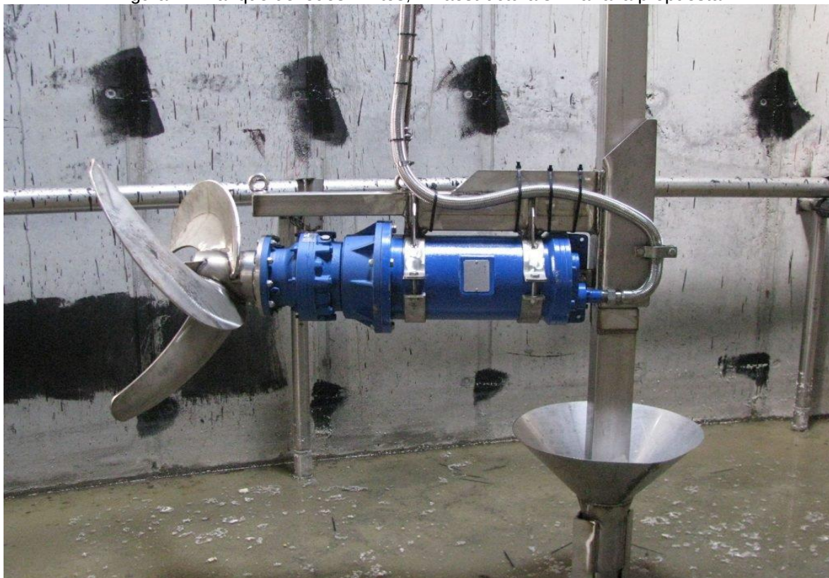
Figura 11. Tanque de lodos mixtos, Infraestructura similar a la propuesta.
