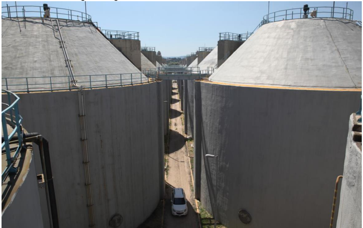
Figura1. Digestores anaeróbicos de lodos en PTAR
