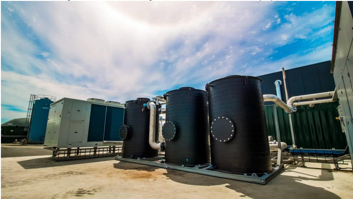
Figura 23. Lavado de biogás, infraestructura similar a la propuesta
