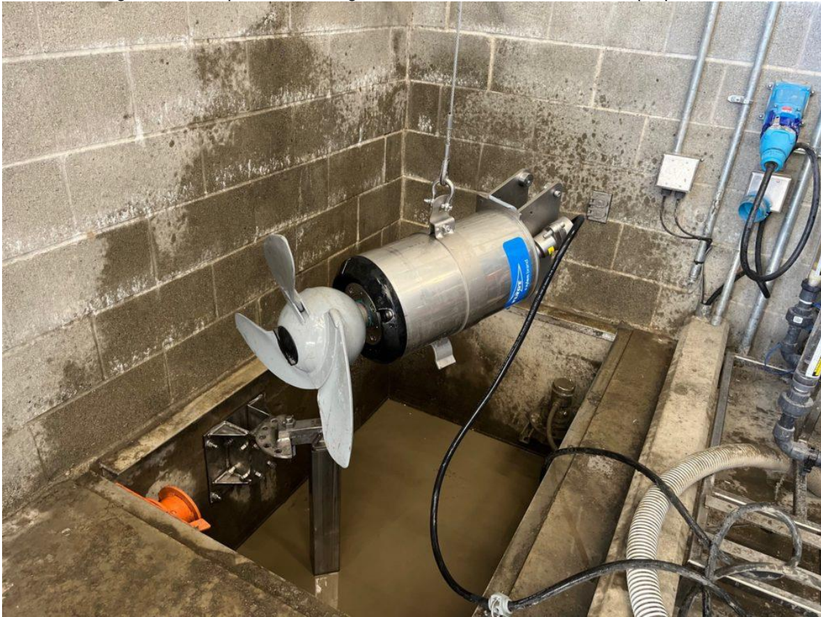
Figura 15. Tanque de lodos digeridos, Infraestructura similar a la propuesta.
