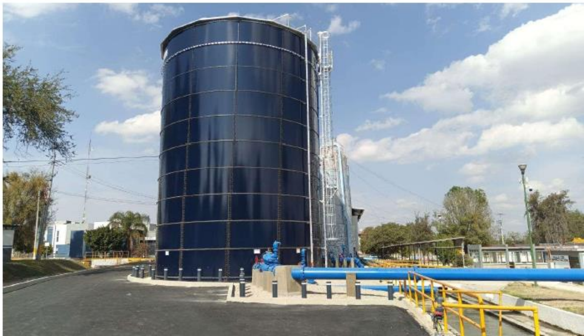
Tanque de retrolavado
